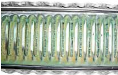
Kalkablagerung durch Verwendung von reinem Wasser (ohne Kühlmittel)
