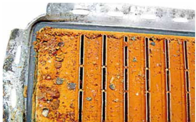
Korrosionsablagerungen im Kühler
