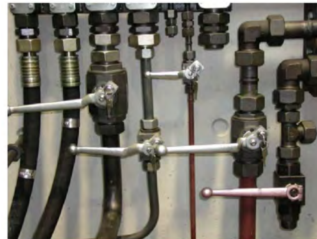
Bild 3: Sichern gegen Wiedereinschalten durch abschließbare Kugelhähne
