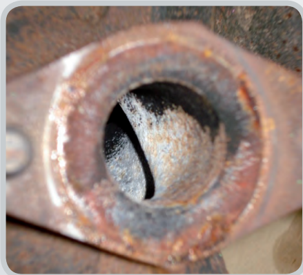
Bild Nr. 34: Undichtigkeit zwischen Kühlkörper und Regeleinrichtung verursacht weißlich-rostige Ablagerungen
