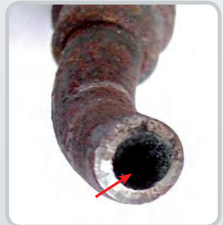
Bild Nr. 39: Verkockte Leitung mit thermischer Verfärbung
